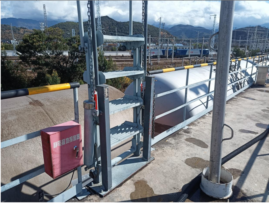
图2-7 栈桥上方设置的静电接地报警仪
