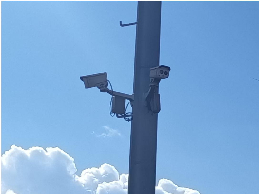
图 2-5 卸油区视频监控探头
