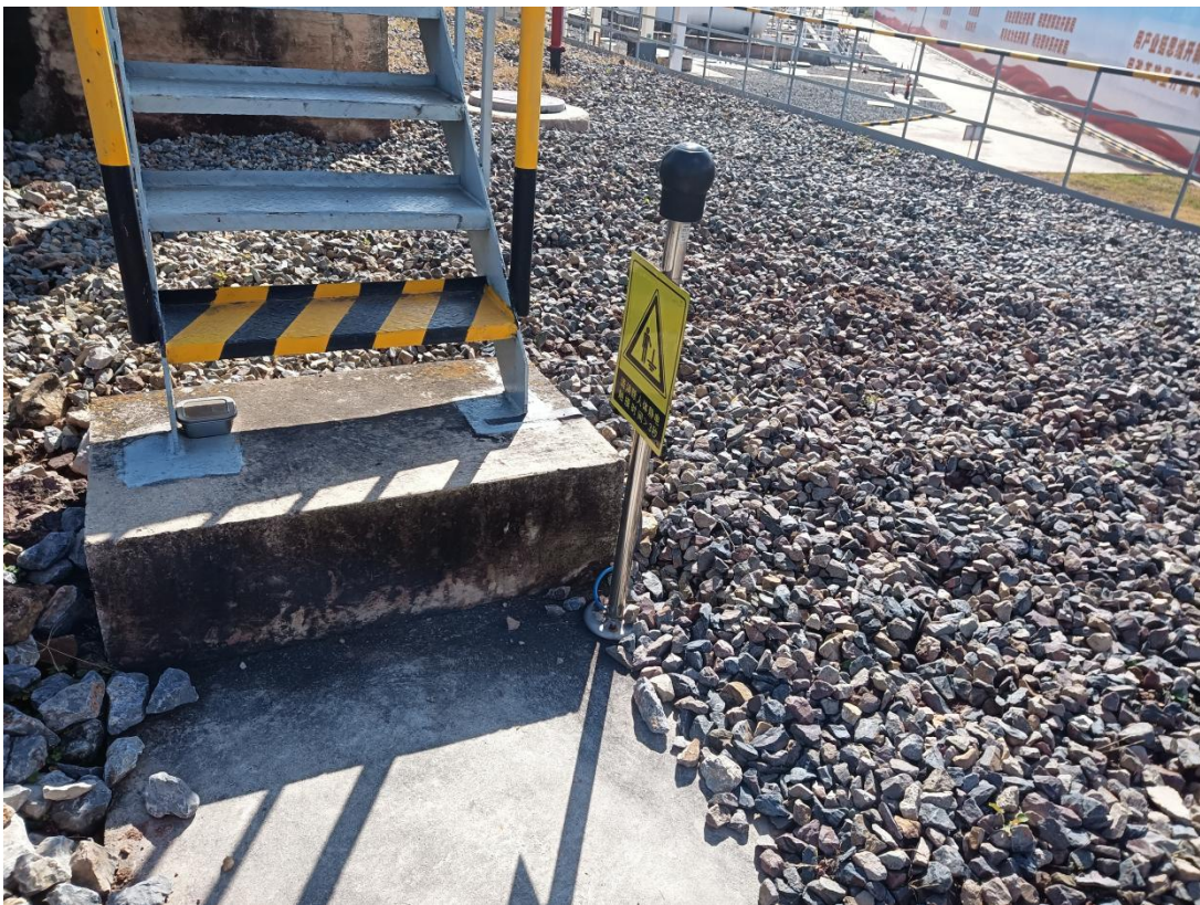
图 2-8 栈桥下方人体静电导除装置
