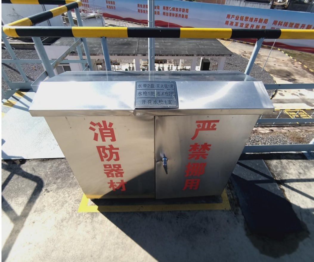
图2-6 应急物资、消防设施
