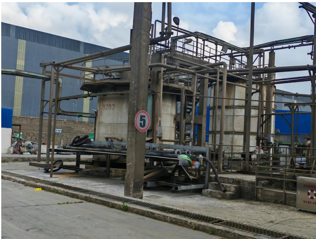
图 F1-6 双氧水储槽
