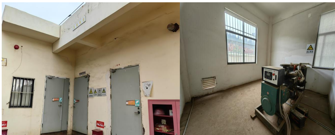
配电室及柴油发电机房
